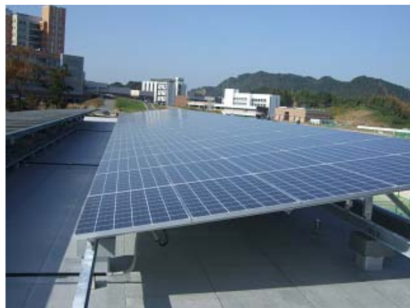
課外活動施設屋上の太陽光発電
