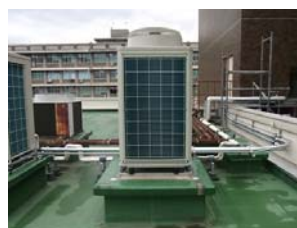
（改修後）室外機
